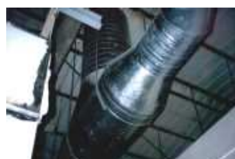
Gaines d'extraction Base Marine
