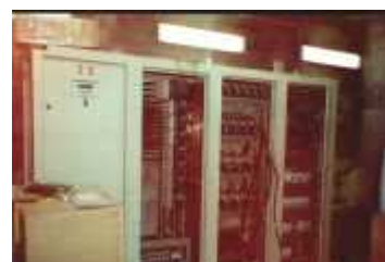
TGBT 2 Le Méridien Bora en cours de chantier
