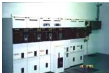
Poste 1 Aéroport de Prague
