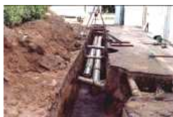
Réseau eau glacée Jean Prince
